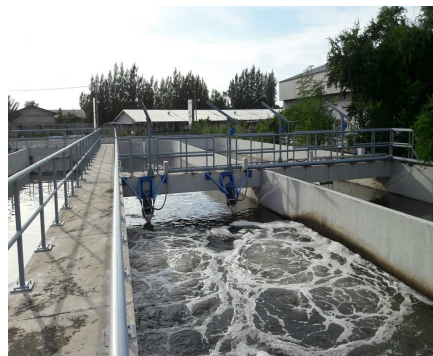
บ่อบำบัดน้ำเสีย
